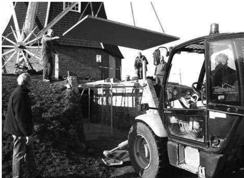
Het plaatsen van de nieuwe dekplaten met behulp van de machine van Bouwbedrijf Oolthuis.. Foto: Frits van Lochem
