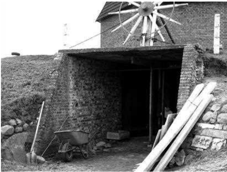
De betonnen dekplaat en het metselwerk dat door de tand des tijds is aangetast. Foto Gerrit Bosman
