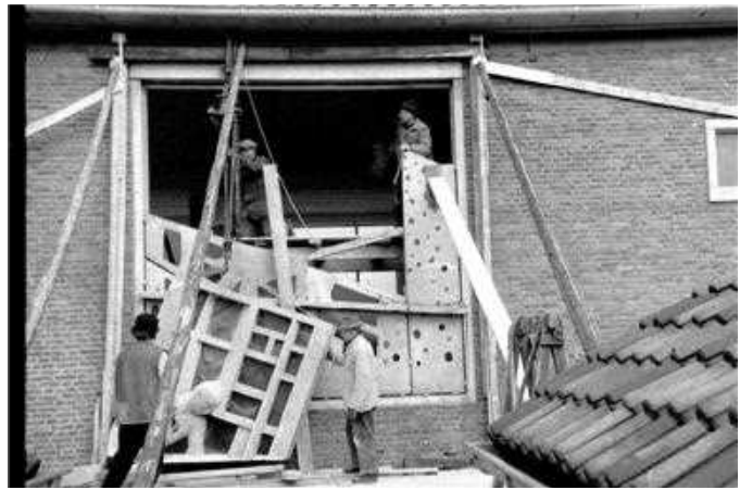
Een deel van het betonrelief van Marius van Beek wordt omhoog getakeld. Moderne mobiele kranen voor zwaar hijswerk waren er nog niet.
