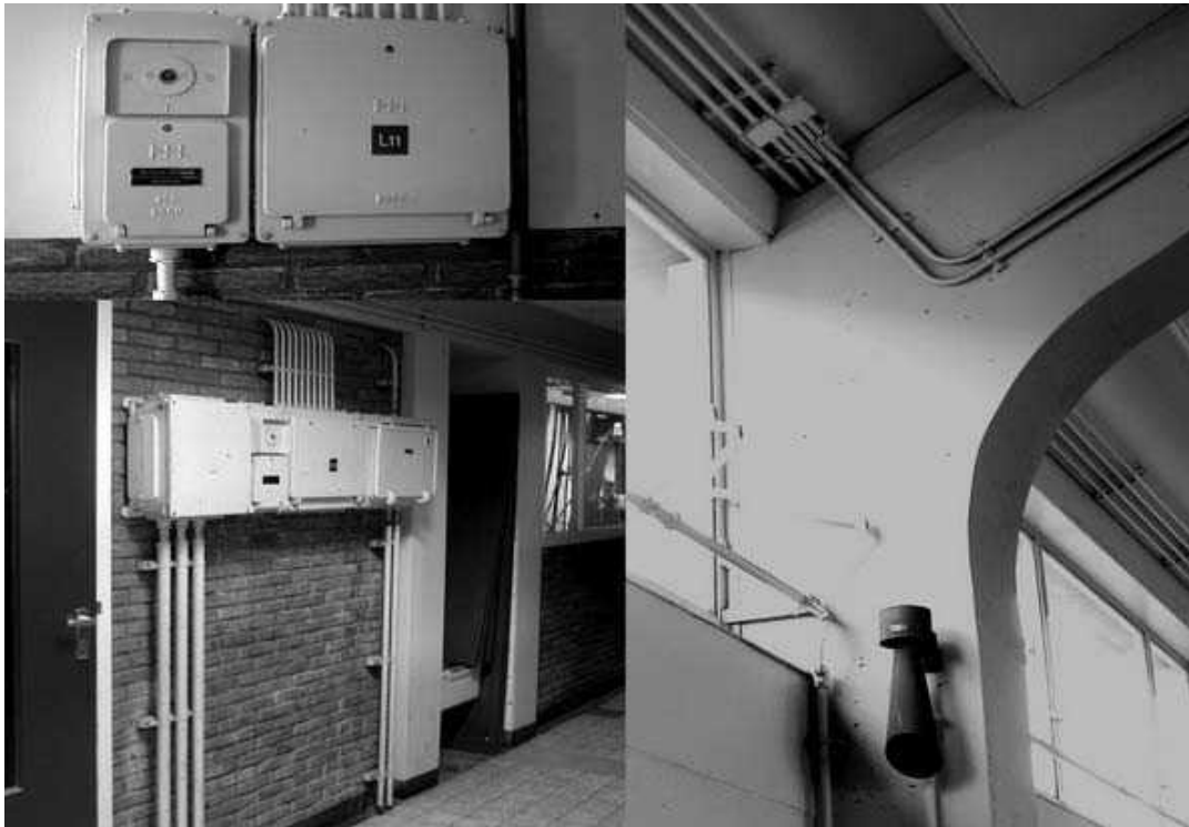
Compositiefoto van de vele elektrische leidingen en schakelkasten in het gebouw. Eind jaren vijftig werden leidingen op voorschrift van de Rijksgebouwendienst 'inzicht' gelegd. Het verloop van de leidingen moest zichtbaar zijn. In zicht liggende buizen werden los van de wand op een voorgeschreven afstand met zadels vastgezet.
