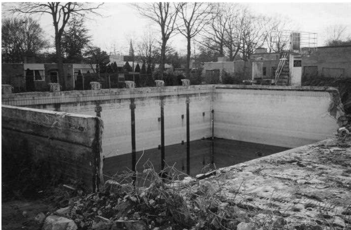
De sloop van het diepe bad. De springplank en de startblokken staan nog overeind, het bassin is reeds voor een deel gesloopt.
